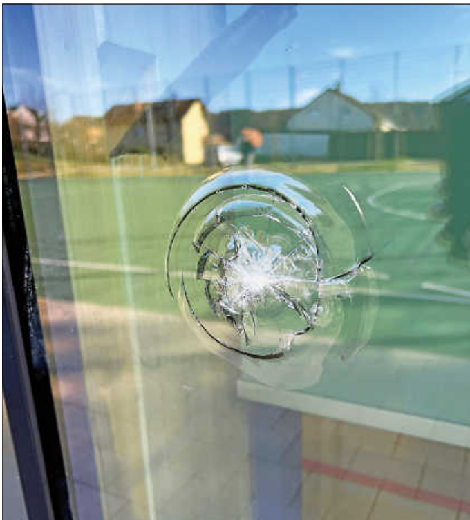
Glasschaden an der Heynlinturnhalle. Neben dieser wurden noch weitere Scheiben beschädigt.
