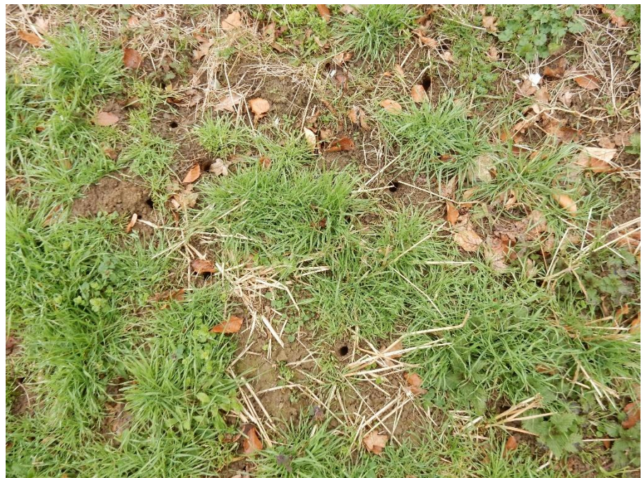
Foto 4: Mäuselöcher entlang des Damms.
