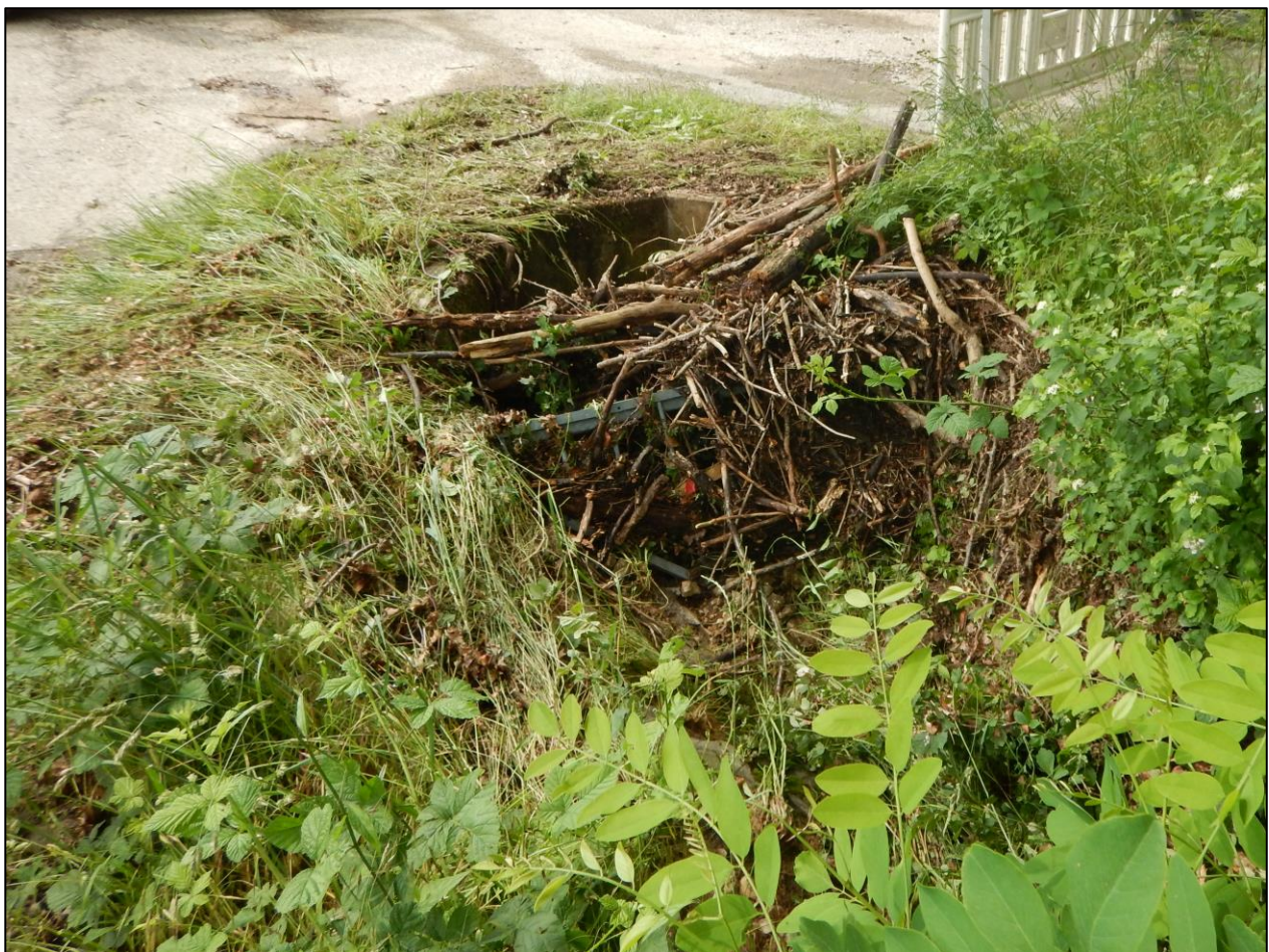
Abbildung 7.4: Verklauster Straßendurchlass des Zulaufgrabens, LT1
