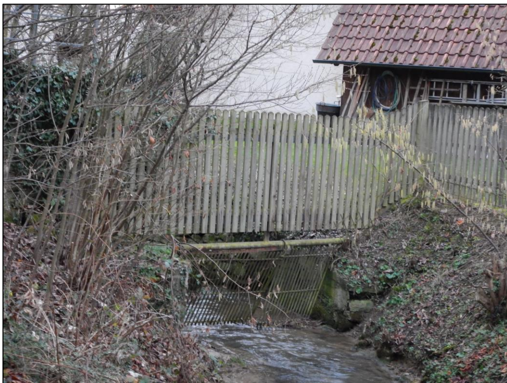
Abbildung 8.3: Abflusshindernis am Bruchbach, Gitter und Zaun, Aufnahme seitlich
