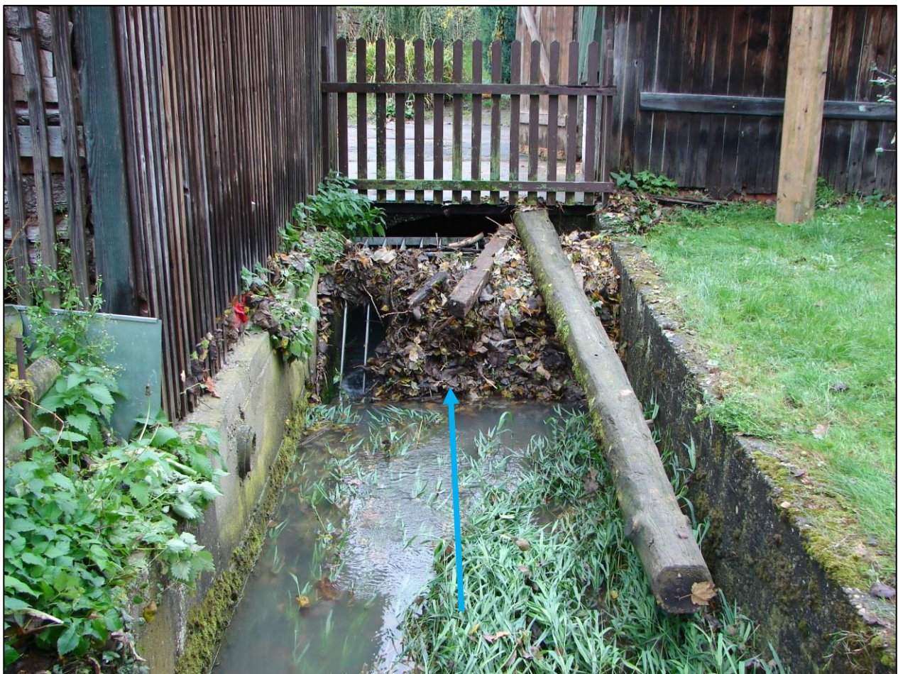
Abbildung 7.16: Verdolungseinlauf Gennenbach, Verlegung des Einlaufrechens ohne HW-Abfluss vom 09.10.2008 (Quelle: Anwohner)
