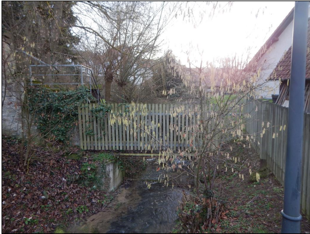
Abbildung 8.2: Abflusshindernis am Bruchbach, Gitter und Zaun, Frontalaufnahme
